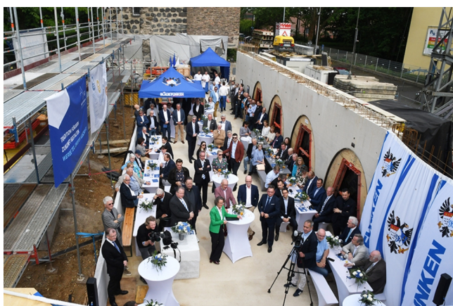
Der Entlastungsbau wächst in die Höhe: die ersten architektonischen Details sind für die Gäste des
